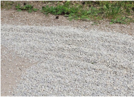
Gefährliche Anhäufung von Kalksteinsplitt
